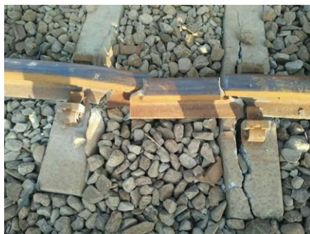
Gambar 1. Rel patah di KM 8+625
